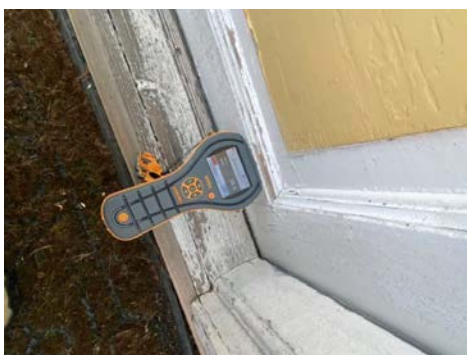
Målt høye fuktverdier i ytterdør.
