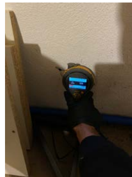
Fuktsøk med indikasjoner på fukt i betongvegger.
