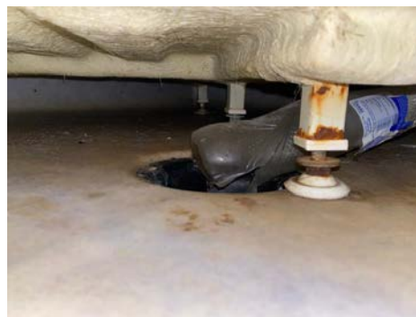
Sluk med ufagmessig utførelse på vannrør fra kabinett.
