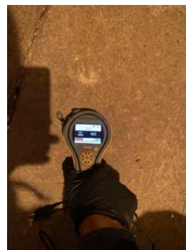
Fuktsøk med indikasjoner på fukt i betonggulv.
