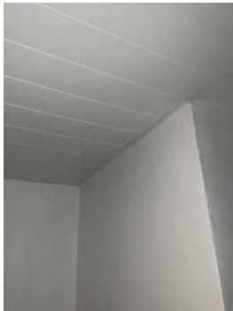
Panel ført helt inntil mursteinspipe.
