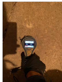
Fuktsøk med indikasjoner på fukt i betonggulv.
