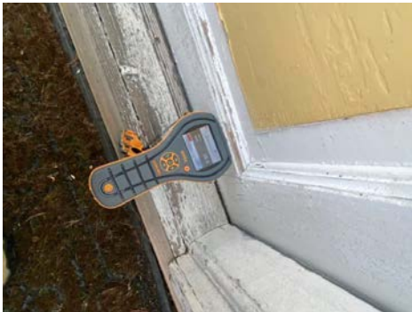
Målt høye fuktverdier i ytterdør.
