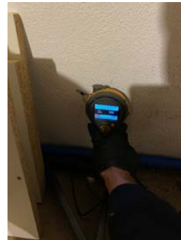
Fuktsøk med indikasjoner på fukt i betongvegger.
