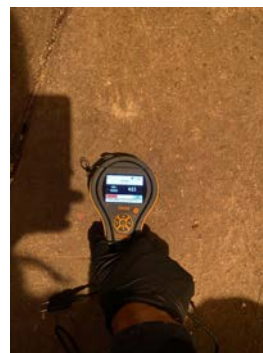
Fuktsøk med indikasjoner på fukt i betonggulv.
