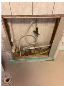
Ufagmessig utførelse på røropplegg. Evt. lekkasje vil ikke føres til sluk.
