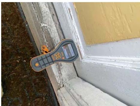
Målt høye fuktverdier i ytterdør.
