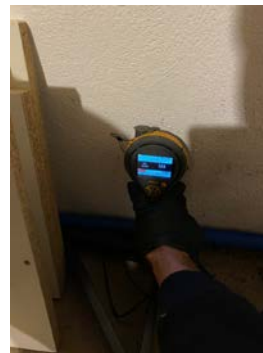
Fuktsøk med indikasjoner på fukt i betongvegger.
