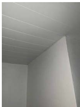
Panel ført helt inntil mursteinspipe.
