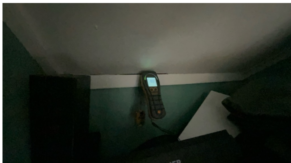
Ingen unormale fuktindikasjoner ved misfarge på befaringdagen.
