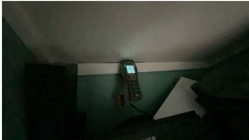
Ingen unormale fuktindikasjoner ved misfarge på befaringdagen.
