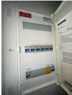
Sikringskap med automatsikringer.
