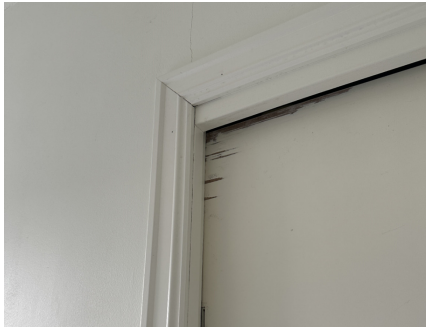
Slitasje på dørblad mot soverom
