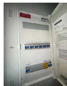
Sikringsskap med automatsikringer.
