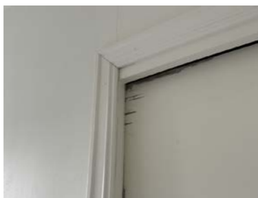
Slitasje på dørblad mot soverom
