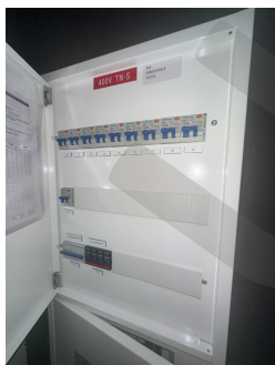
Sikringsskap med automatsikringer.
