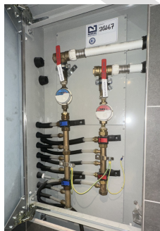
Samleskap med rørkurser og stoppekraner
