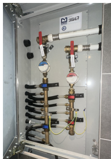
Samleskap med rørkurser og stoppekraner
