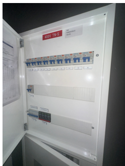
Sikringsskap med automatsikringer.
