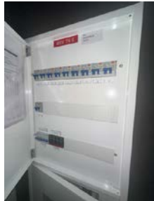
Sikringsskap med automatslukninger.
