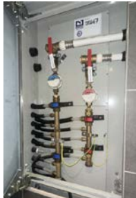
Samleskap med rørkurser og stoppekraner
