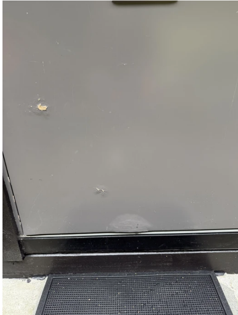
Dørblad har skader og oppsvulming
