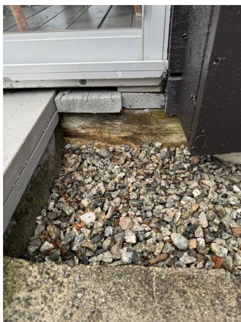
Bjelke har påbegynte råteskader
