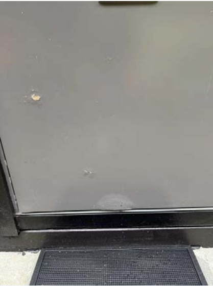
Dørblad har skader og oppsvulming
