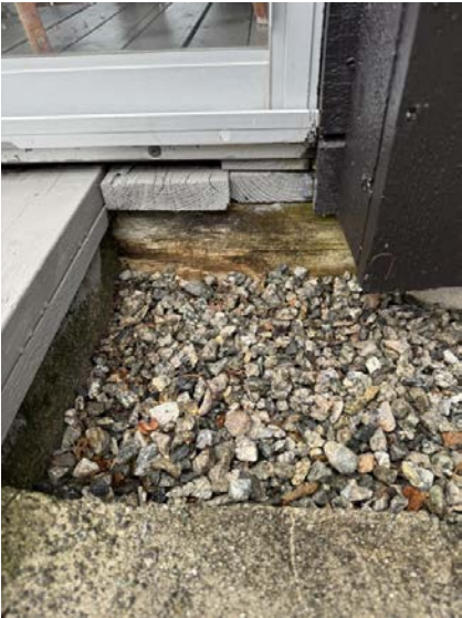
Bjelke har påbegynte råteskader
