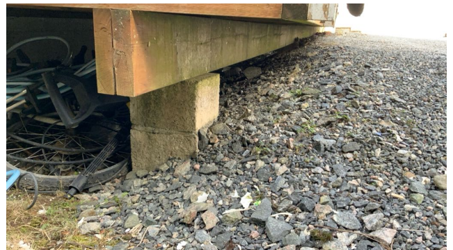
Kontroll av fundament. Kommende lokale utbedringer kan ikke utelukkes på sikt.
