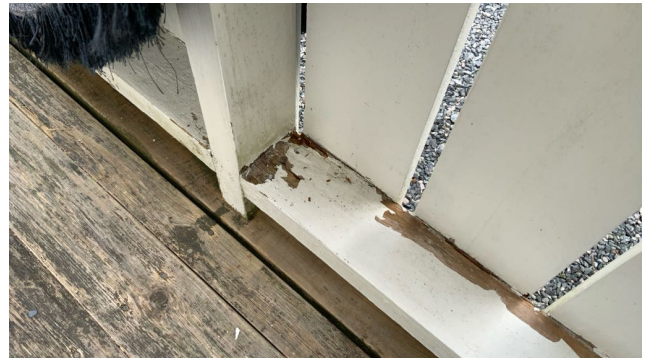
Stedvis råteskadet konstruksjoner.
