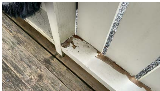
Stedvis råteskadede konstruksjoner.
