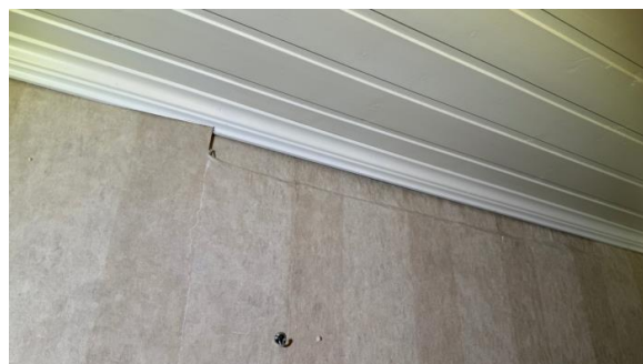
Skade i tapeten.
