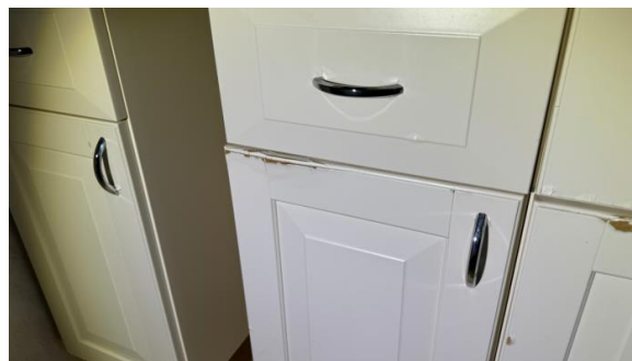
Baderomsinnredning har en del fuktsvell.
