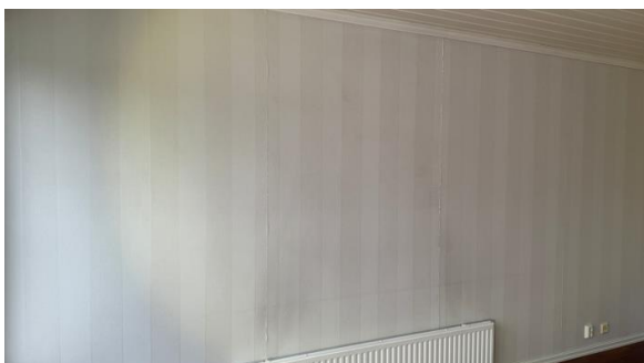
Skade i tapeten.
