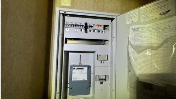
Kontroll av el-skap og kursfortegnelse.
