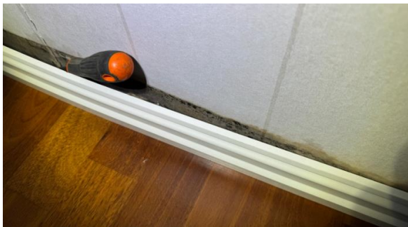
Det er registrert muggsopp bak lister i stuen.
