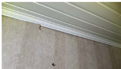
Skade i tapeten.
