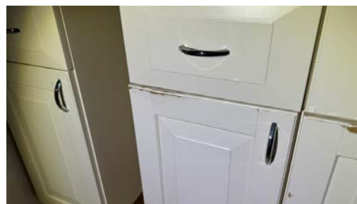
Baderomsinnredning har en del fuktsvell.
