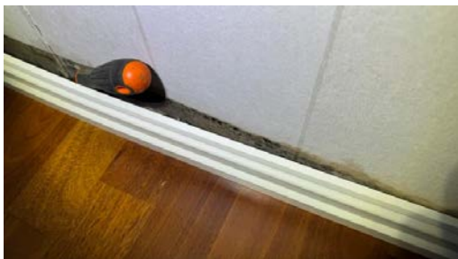
Det er registrert muggsopp bak lister i stuen.
