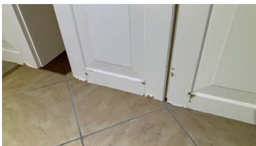
Baderomsinnredning har en del fuktsvell.
