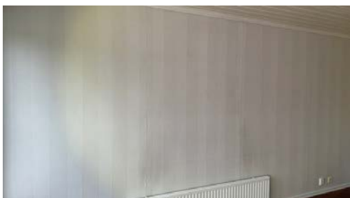
Skade i tapeten.
