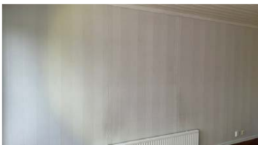
Skade i tapeten.
