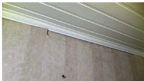
Skade i tapeten.
