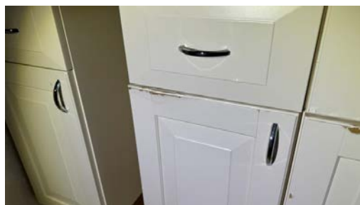
Baderomsinnredning har en del fuktsvell.
