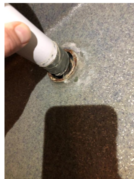
Bilde av avløp fra servant på badet
