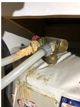
Bilde av kobling på varmtvannsbereder
