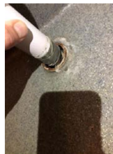
Bilde av avløp fra servant på badet
