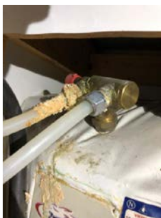
Bilde av kobling på varmtvannsbereeder
