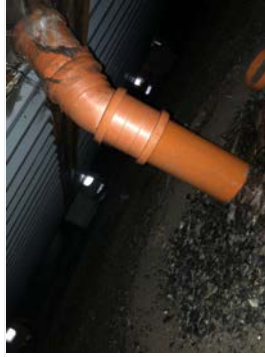
Bilde av lekkasje på/ved avløprør i krypkjeller
