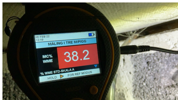
Fukt og råteskader i bunnsvill mot nord/øst.
