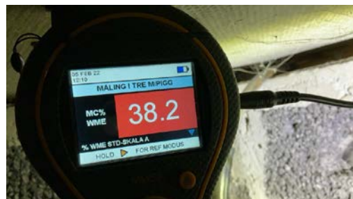
Fukt og råteskader i bunnsvill mot nord/øst.
