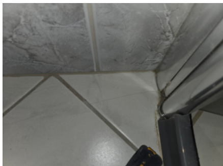
Sprekk i fliser i dusj mot vegg
