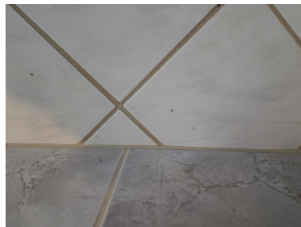
Sprekk i fliser i dusj mot vegg
