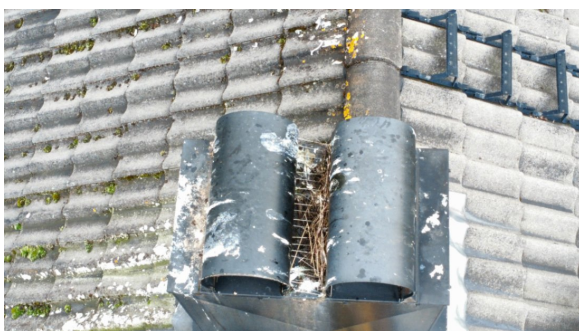
Er en del avfall fra fugler på pipehatt.
