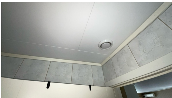
Avtreksventil i himling
