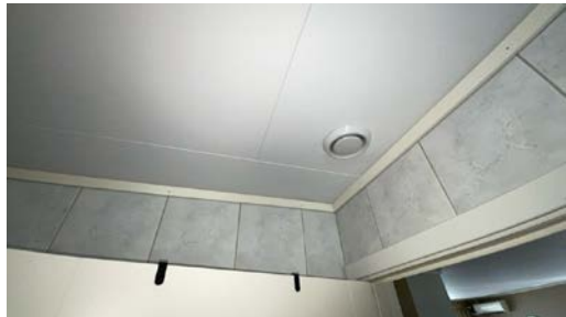
Avtrekkssventil i himling
