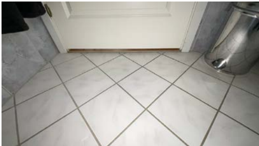
Tilluftsspalte under dør
