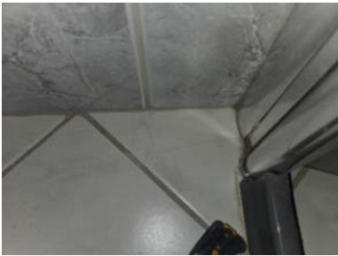
Sprekk i fliser i dusj mot vegg
