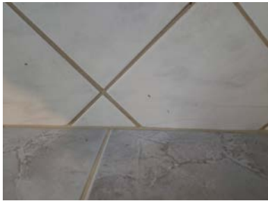
Sprekk i fliser i dusj mot vegg
