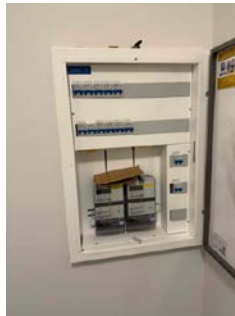
Bildet viser sikringsskapet for leiligheten og naboileiligheten.
