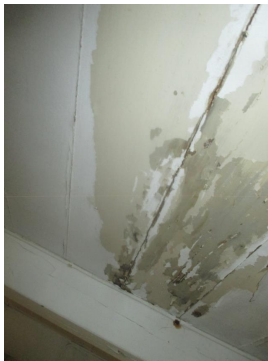
Skader på vegger etter lekkasjer.
