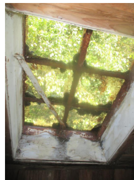
Gammelt skadet takvindu av støpejern.
