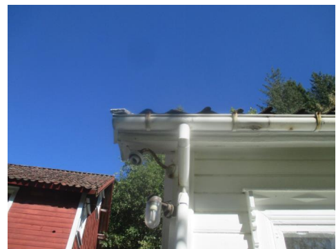
Eldre takrenner og nedløp.
