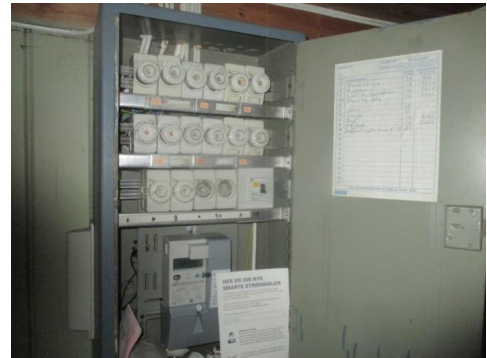
Sikringsskapet er plassert i gangen på loftet.
