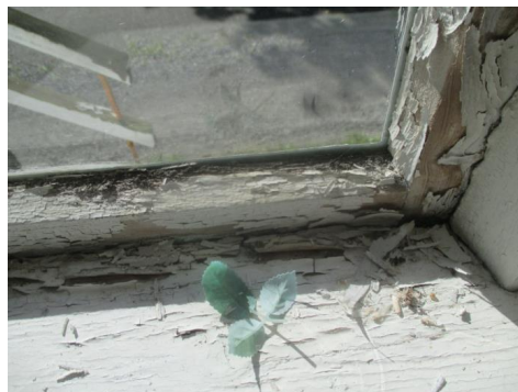
Innvendige skader på karm og ramme.
