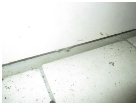
Fuger har åpnet seg noe.
