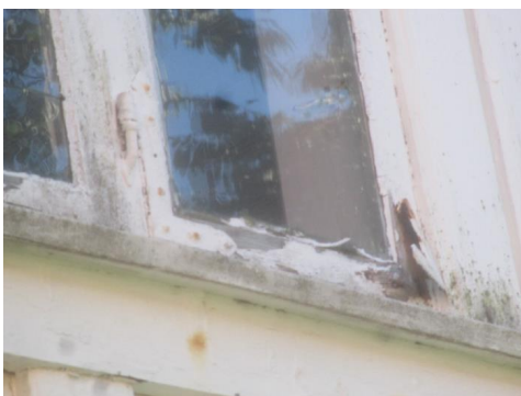
Eldre slitte/skadet vinduer.
