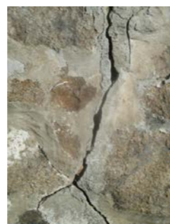
Større sprekk og sig på ene ytterhjørne i mot vei.
