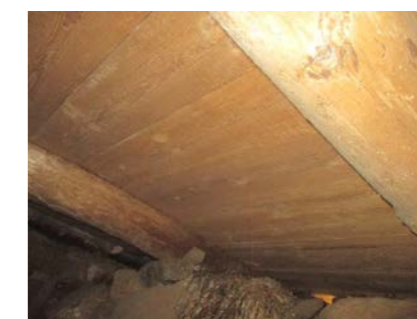
Fuktskade på gulbjelke av rundstokk ved grunnmur.
