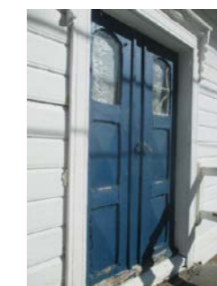
Gammel og skadet hoveddør.
