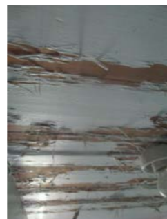
Skader etter lekkasjer i himling på soverommet.
