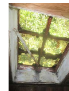
Gammelt skadet takvindu av støpejern.
