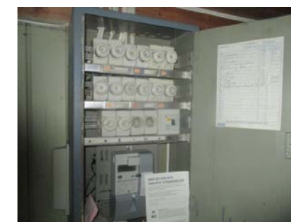
Sikringsskapet er plassert i gangen på loftet.
