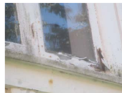
Eldre slitte/skadet vinduer.
