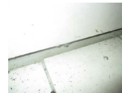
Fuger har åpnet seg noe.
