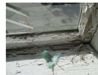
Innvendige skader på karm og ramme.
