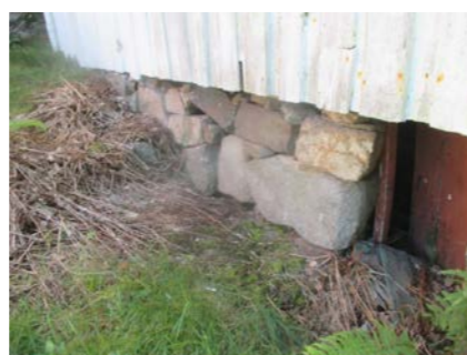
Tøttstabet mur på enden av bygningen mot låve.
