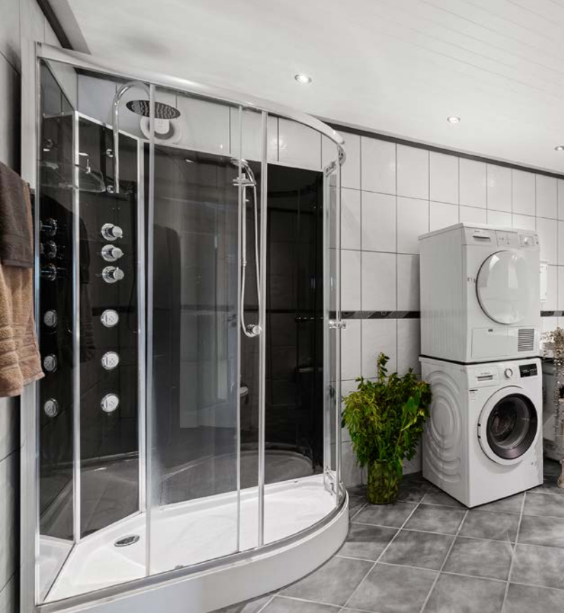
Romslig, helfislet baderom med stor innredning og integrert plass til vaskemaskin og tørketrommel.
