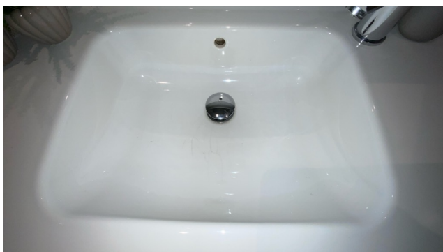
Rissdannelser på servant.
