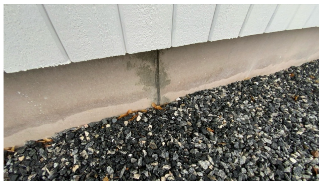
Synlig riss i overganger.
