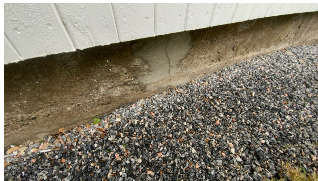
Synlig riss i overganger.
