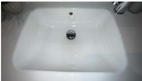
Rissdannelser på servant.
