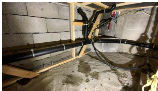
Nye avløpsrør synlig i krypkjeller.
