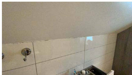
Silikonovergang på himling og vegg bør utbedres.
