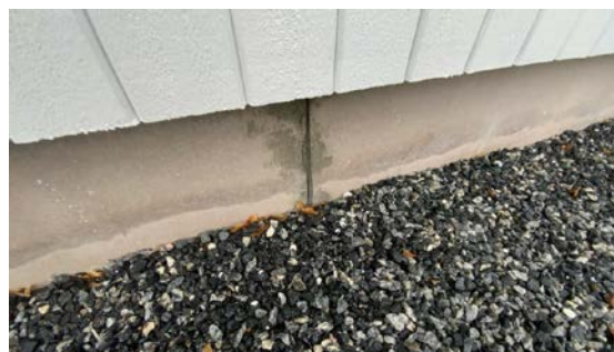
Synlig riss i overganger.
