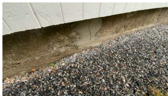
Synlig riss i overganger.
