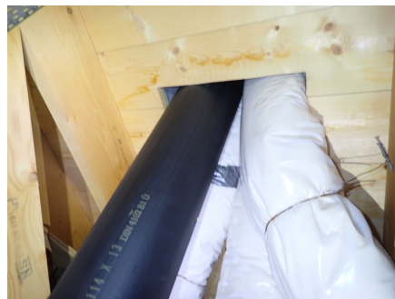
Fuktmerker rundt kanal på kaldloft.
