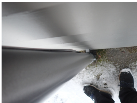
Frostspreng i nedløpsrør.
