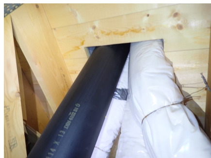
Fuktmerker rundt kanalen.
