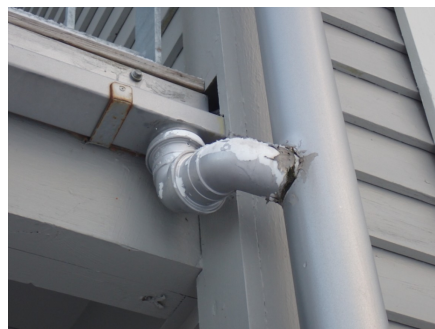
Risiko for utettheter ved overgang mellom rørdeler.
