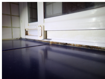
Svertesopp i fuger.
