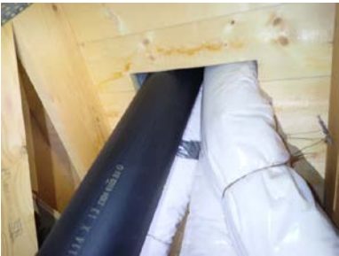
Fuktmerker rundt kanalen.
