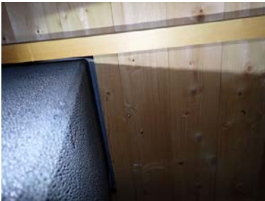
Drypper litt fra dette hjørnet ved pipe i overgang over tak.
