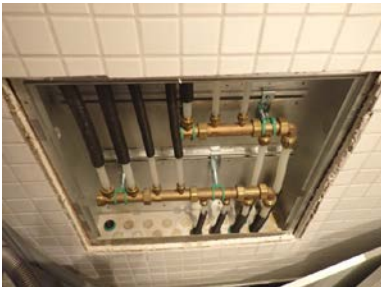
Rørstokk (rør i rør).
