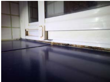
Svertesopp i fuger.
