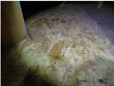
Fuktig på plate under kanal som fører over tak.
