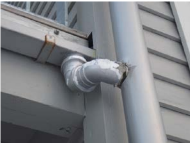
Risiko for utettheter ved overgang mellom rørdeler.
