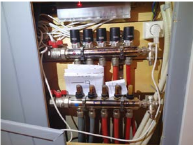
Rørstokk (vannbåren varme).
