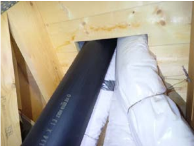
Fuktmerker rundt kanal på kaldloft.
