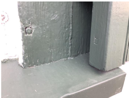
Omramming rundt vinduer er ført helt ned til vannbrett.
