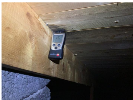
Fuktskjolder ved pipe, men det måles tørt på befaringsdagen.
