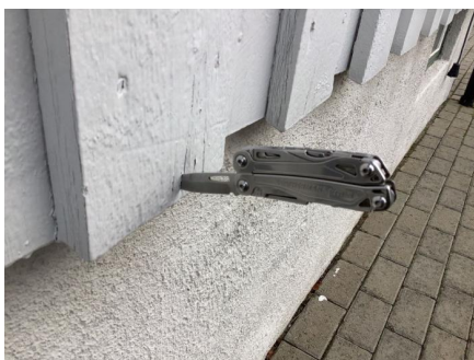
Eksempel på spredt råteskade på boligen.
