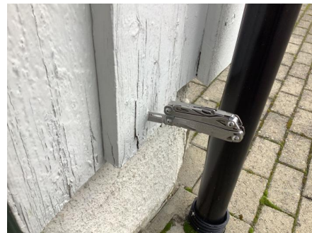
Eksempel på spredt råteskade på garasje.
