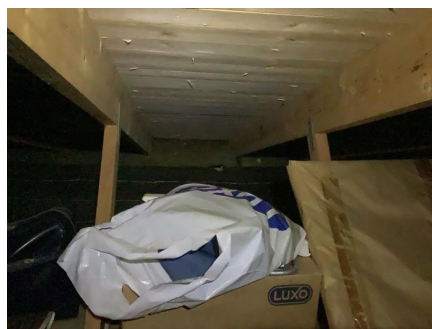
Mangelfull ventilering fra takfot / gesims.
