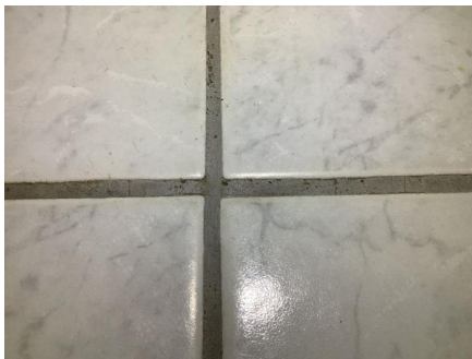
Riss i flisfuger i dusj.
