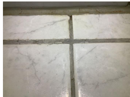
Riss i flisfuger i dusj.
