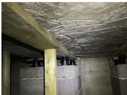
Sprekkdannelse er understøttet.
