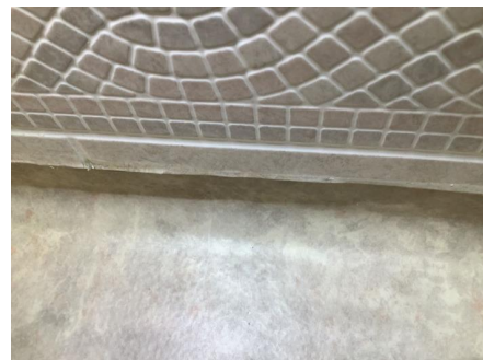
Tegn til fuktskader i nedkant av baderomsplater.
