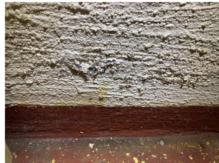
Saltutslag på grunnmur.
