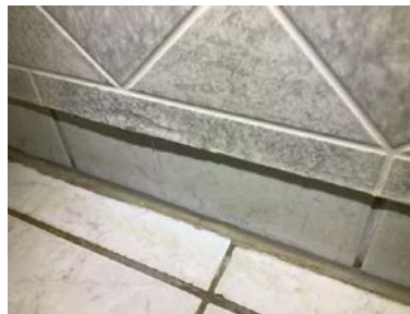
Tegn til fuktskader i nedkant av baderomsplater.
