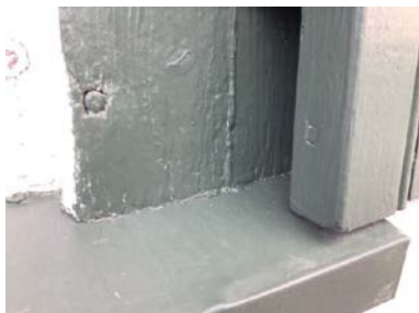
Omrømming rundt vinduer er ført helt ned til vannbrett.
