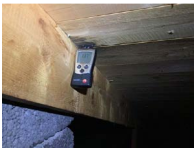
Fuktskjolder ved pipe, men det måles tørt på befaringsdagen.
