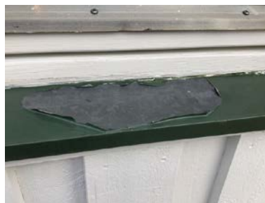
Løstnet maling på vannbrettbeslag.
