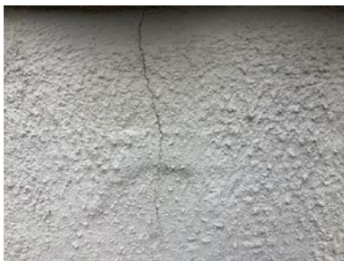
Eksempel på utvendig skråriss.
