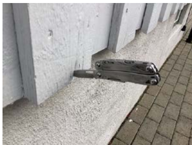
Eksempel på spredt råteskade på boligen.
