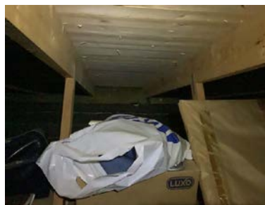
Mangelfull ventilering fra takfot / gesims.
