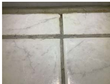
Riss i flisfuger i dusj.
