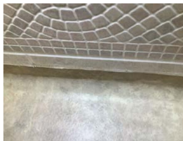
Tegn til fuktskader i nedkant av baderomsplater.
