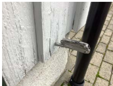
Eksempel på spredt råteskade på garasje.
