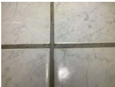
Riss i flisfuger i dusj.
