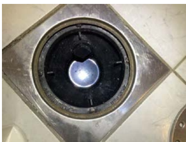
Plastsluk, uten synlig tettesjikt.
