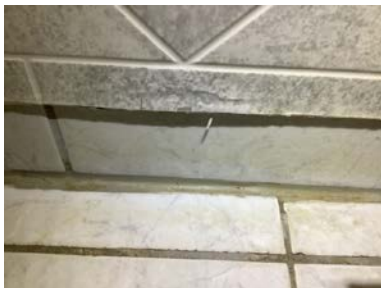
Tegn til fuktskader i nedkant av baderomsplater.
