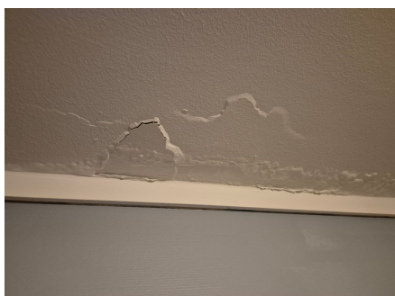
Sprekker i tak i bod.
