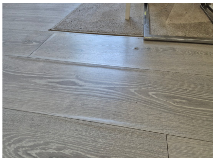
Sveller i laminat og skade.
