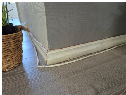
Ledninger som ikke er festet.
