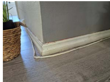
Ledninger som ikke er festet.
