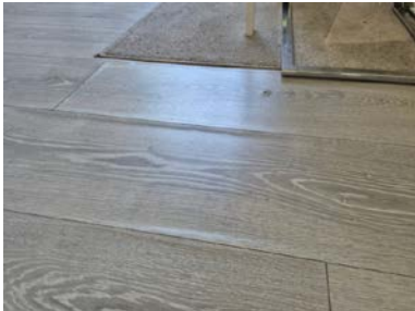
Sveller i laminat og skade.
