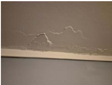
Sprekker i tak i bod.
