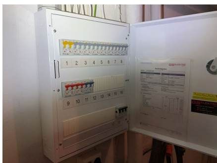
Sikringsskap plassert i kjeller.
