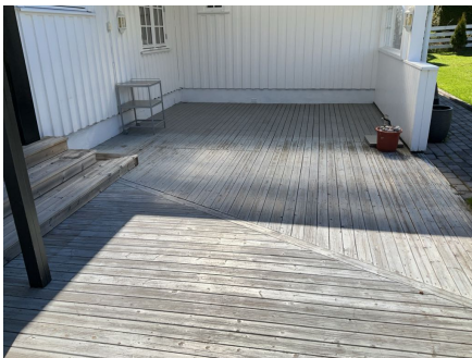
Konstruksjoner/overflater har vedlikeholdsbehov.
