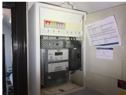
Sikringsskap plassert i loftetasje.
