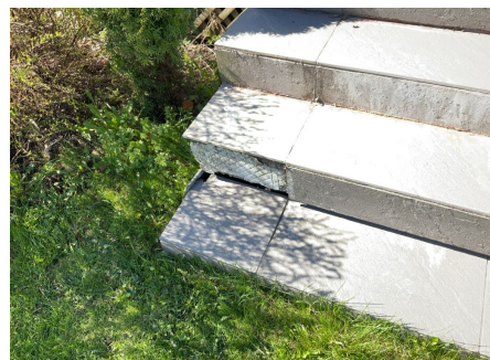
Løs flis på trappen.
