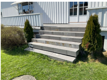
Rekkverk må monteres for å lukke avviket.
