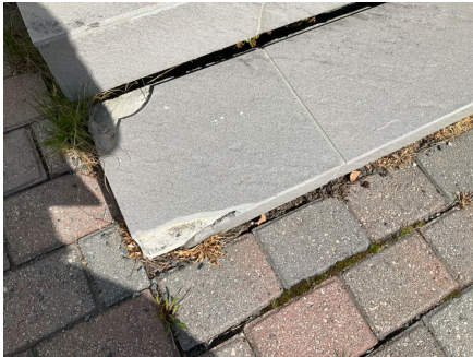
Skadet flis på trapp.
