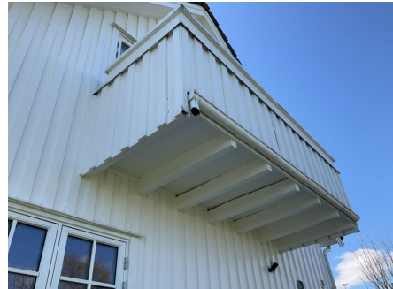
Slitasje/fuktskader på rekkverk ved nedløp.
