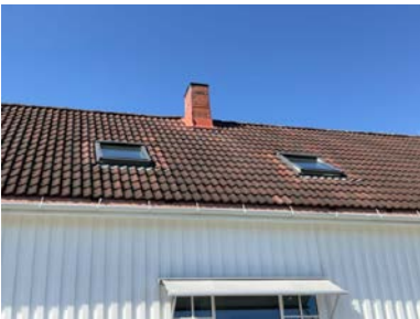
Takvinduer er å betrakte som en risikokonstruksjon, det vil si en konstruksjon som erfaring viser at har høy skadefrekvens. Eksakt tilstand er ikke kontrollerbart uten bygningsmessige inngrep.
