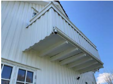
Slitasje/fuktskader på rekkverk ved nedløp.
