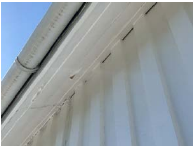
Noe malingsflass oppunder takutstikket.
