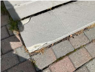
Skadet flis på trapp.
