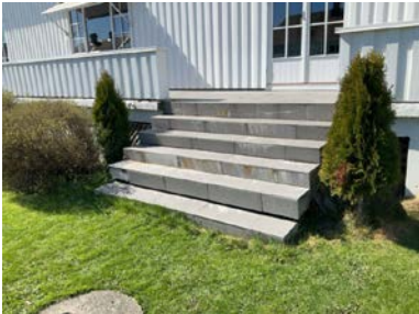
Rekkverk må monteres for å lukke avviket.
