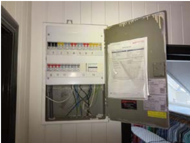
Sikringsskap plassert i loftetasje.
