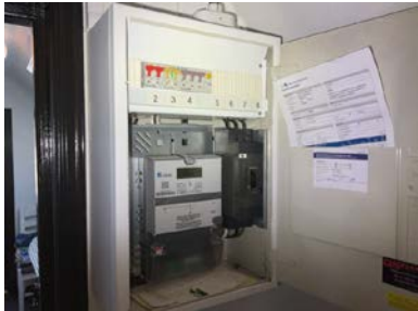
Sikringsskap plassert i loftetasje.
