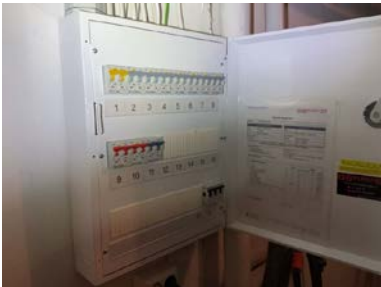
Sikringsskap plassert i kjeller.
