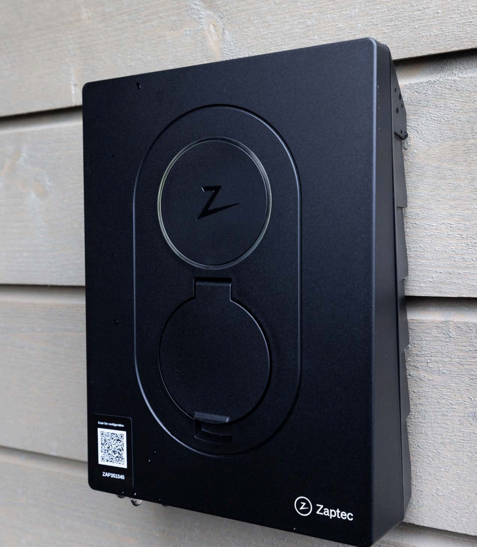
Det er montert Zaptec lader på vegg.
