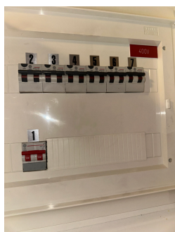
Sikringsskap med automatsikringer.
