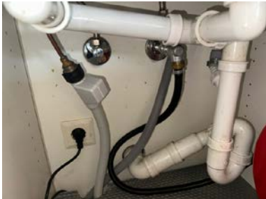
Røropplegg i kjøkkenbenk
