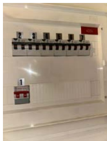
Sikringsskap med automatsikringer.
