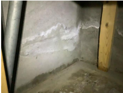
Saltutslag på murvegg.
