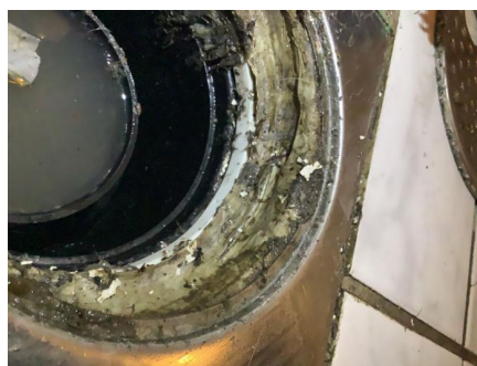
Plastsluk, og det kan se ut til å være noe membranliknende masse rundt sluket.
