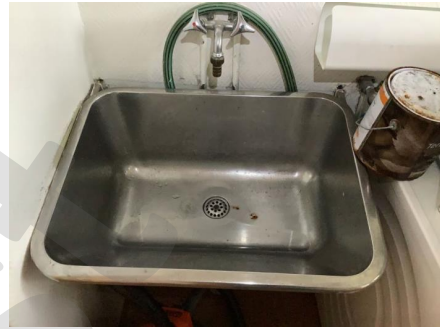
Drypplekkasje fra servantbatteri.
