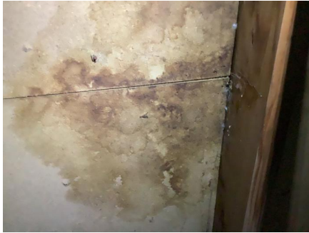
Misfarget undertak over garasje.
