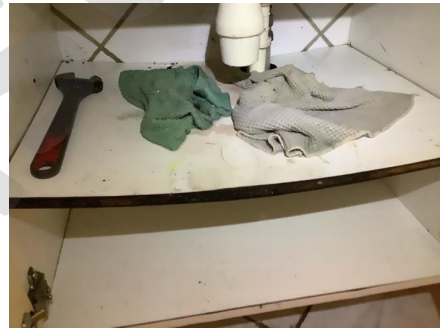
Svellskadet hylleplate, og det er lekkasje fra avløp.
