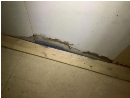
Fuktopptrekk i veggplate.
