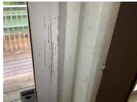
Slitasje på balkongdør.
