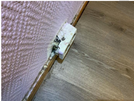
Skadet deksel på stikkontakt.
