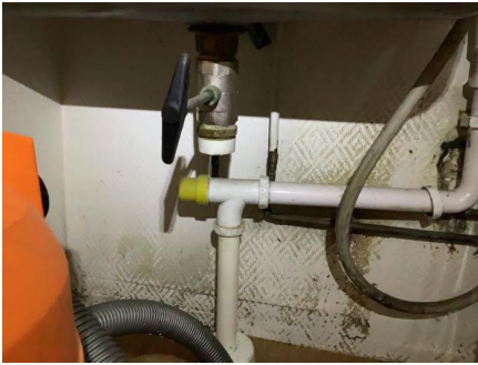
Lekkasje fra vaskekum.
