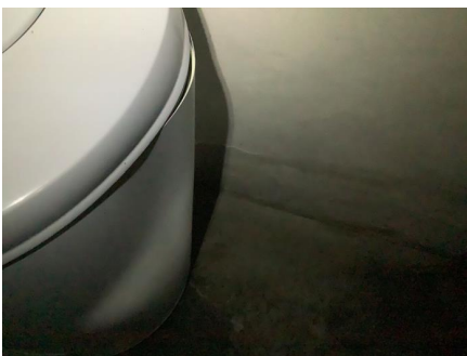
Bulkskade i varmtvannstanken.
