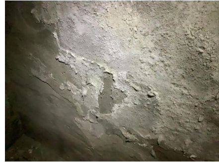
Saltutslag på synlig murvegg.
