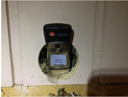
Hulltaking, og treverk er vått.
