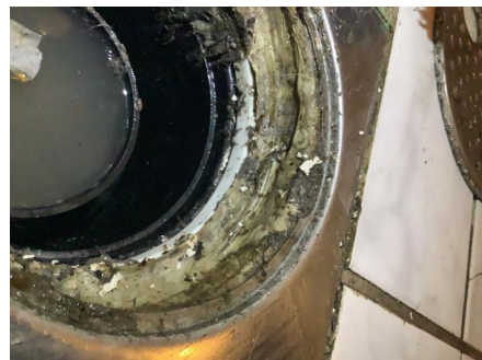
Plastsluk, og det kan se ut til å være noe membranliknende masse rundt sluket.
