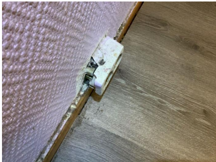
Skadet deksel på stikkontakt.
