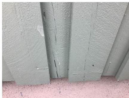
Eksempel på sprukne kledningsbord.
