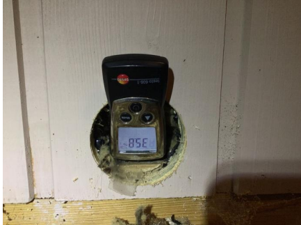
Hulltaking, og treverk er vått.
