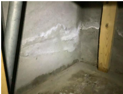
Saltutslag på murvegg.
