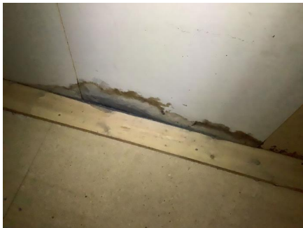
Fuktopptrekk i veggplate.
