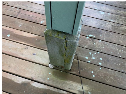
Sprekkdannelse i fundament.
