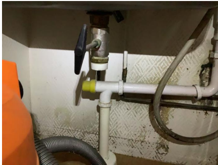
Lekkasje fra vaskekum.
