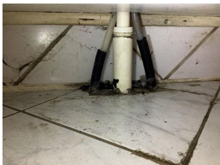
Det mangler tettemuffer i enden av varerrør.
