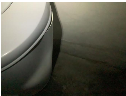
Bulkskade i varmtvannstanken.
