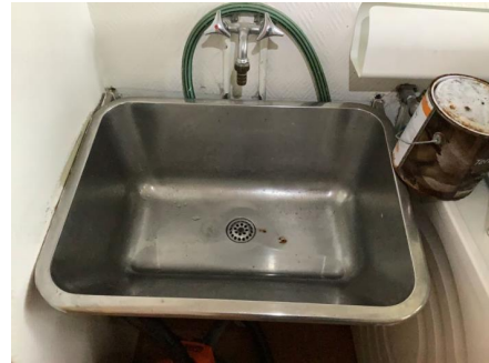
Drypplekkasje fra servantbatteri.
