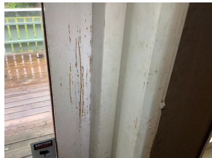
Slitasje på balkongdør.
