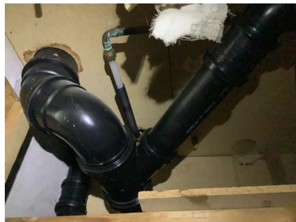
Eventuelt lekkasjevann ledes ikke til sluk og det er ikke lekkasjesikring under varerrør.
