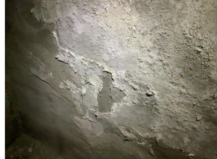
Saltutslag på synlig murvegg.
