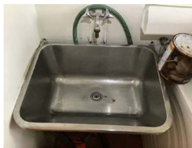
Drypplekkasje fra servantbatteri.
