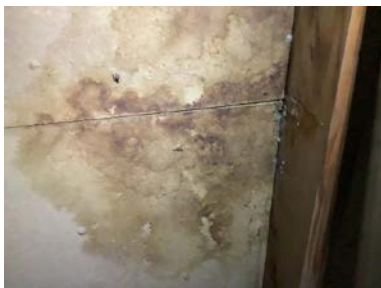
Misfarget undertak over garasje.
