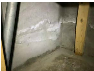
Saltutslag på murvegg.
