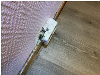
Skadet deksel på stikkontakt.
