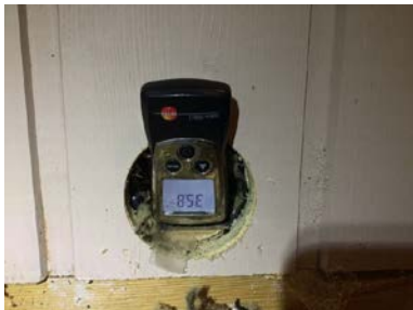
Hulltaking, og treverk er vått.
