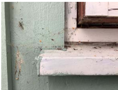
Omrømming rundt vindu er ført helt ned til vannbrett.
