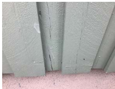
Eksempel på sprukne kledningsbord.
