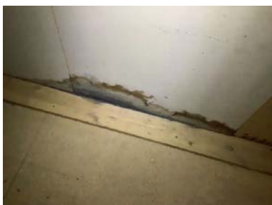
Fuktopptrekk i veggplate.
