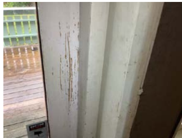
Slitasje på balkongdør.
