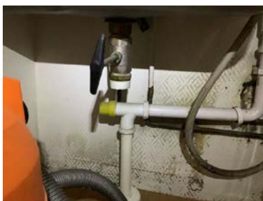
Lekkasje fra vaskekum.
