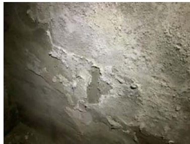
Saltutslag på synlig murvegg.
