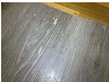
Skadet laminatgulv og manglende overgangslist.
