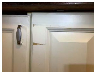
Skade på skapdør, og skjev dør.
