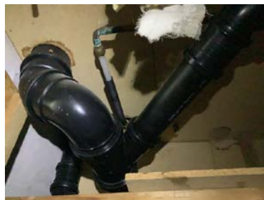
Eventuelt lekkasjevann ledes ikke til sluk og det er ikke lekkasjesikring under varerrør.
