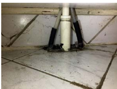
Det mangler tettemuffer i enden av varerrør.
