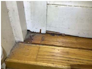
Slitasje på balkongdør.
