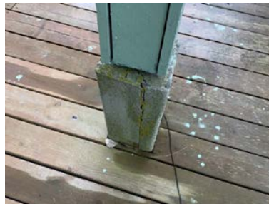
Sprekkdannelse i fundament.
