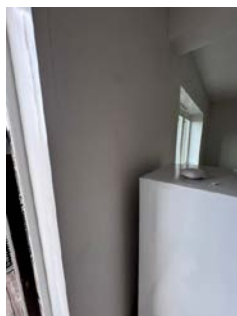
Ventilen er stengt igjen på innsiden
