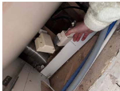
Tekniske stikkontakter er ikke festet under kjøkkeninnredningen. Disse må festes fagmessig av en elektriker.
