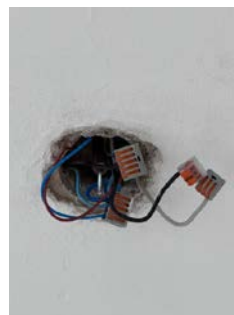
Løst takboks i stuen mangler. Dette må monteres.
