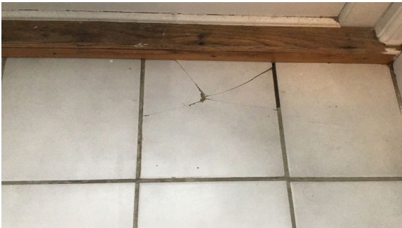
sprekk i flis
