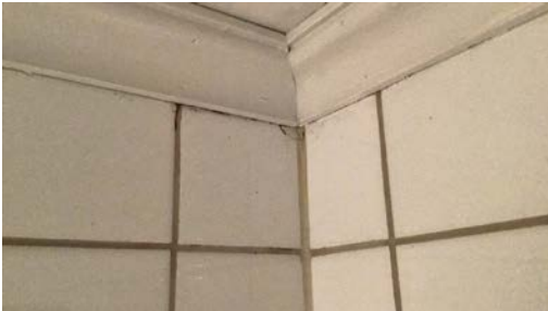
sprekk i flis
