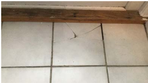
sprekk i flis
