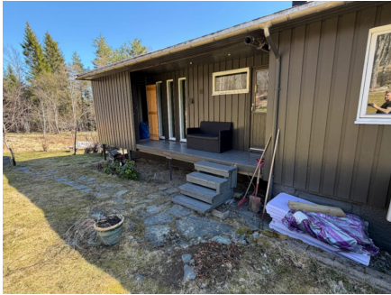
Balkong/ trapp mangler rekkverk.
