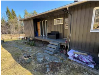
Balkong/ trapp mangler rekkverk.
