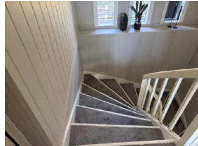
Åpninger er større en 10 cm og det mangler håndløper.
