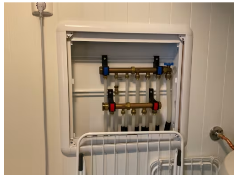
Fordelerskap til vann
