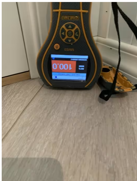
Viser fuktmåling i laminat.
