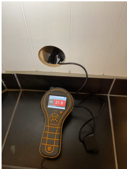
Fuktmåling i tilstøtende rom.
