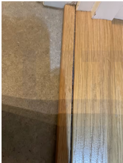
Mangledne tettesjikt ved dør.
