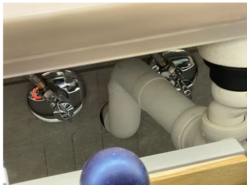
Manglede tetting rundt rørgjennomføring.
