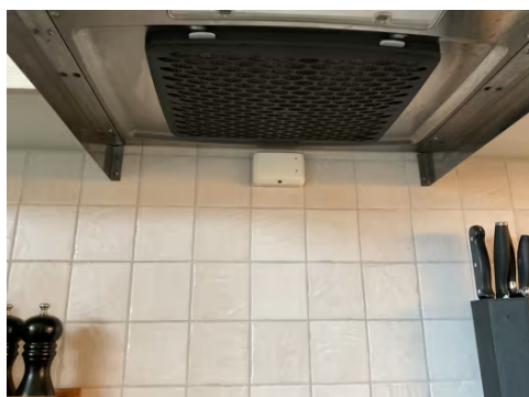
Ventilator og komfyrvakt.
