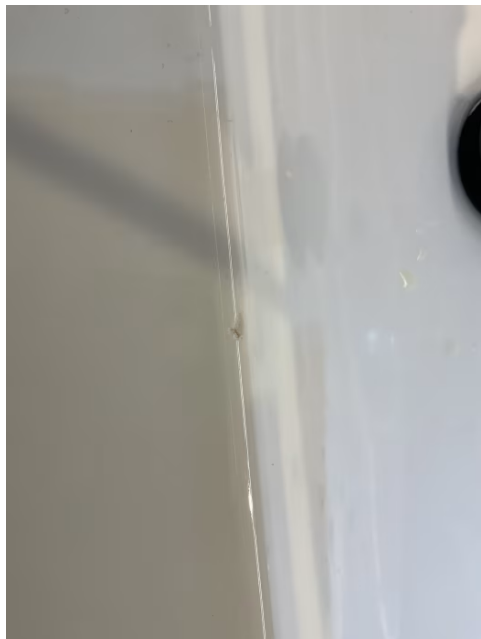
Avskalling på servant.
