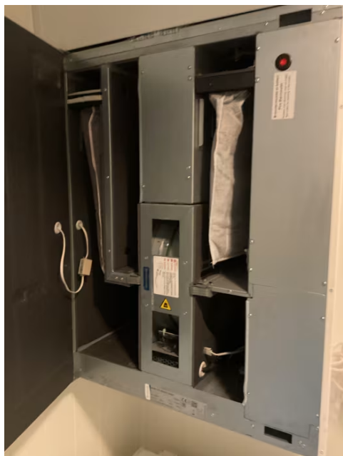
Aggregat for ventilasjon
